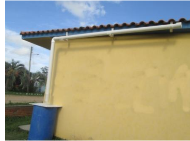
Figura 2: Calha para captação da água da chuva
