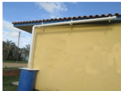
Figura 2: Calha para captação da água da chuva
