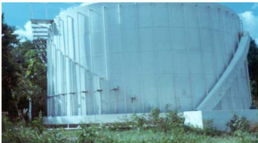
FIGURA 03 - GENARO (2004) - Biodigestor, bairro Três Barras, Cuiabá-MT.
