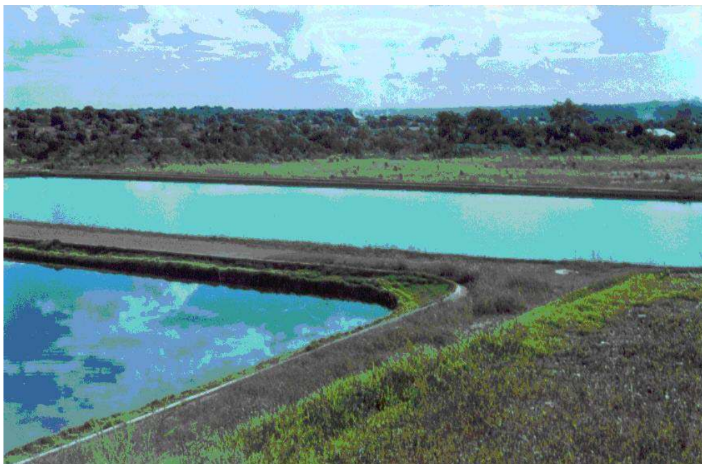
FIGURA 02 - GENARO (2004) - Lagoas de estabilização, bairro Tijucal, Cuiabá-MT. Na figura 03 é mostrado o tratamento de esgoto através de biodigestor, localizado no bairro Três Barras.
