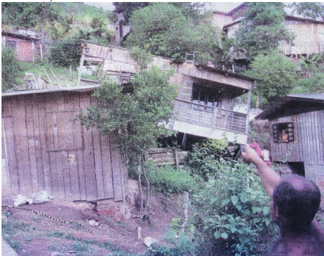
Foto 2 – Residência atingida por deslizamento, Rua Inácio Severino, Bairro Fortaleza.
