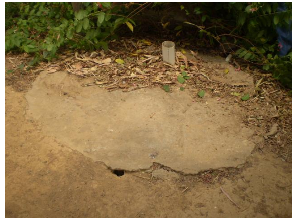
Figura 5. Fossa séptica, ausência de rede de esgoto. (Foto: Jaime Figueiredo)
